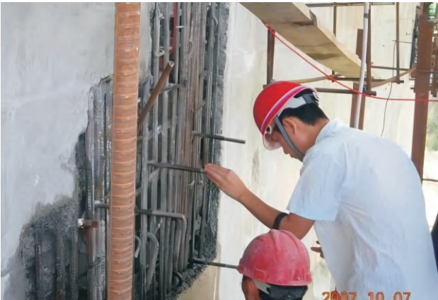
福建浦南高速延安大桥深层缺陷处理
