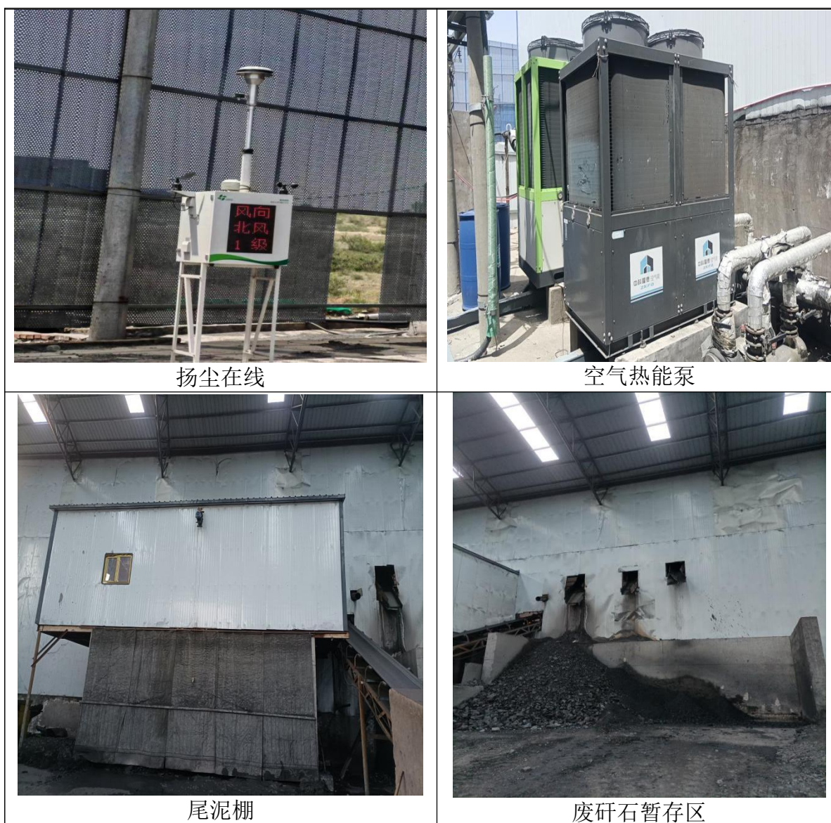
图 3-1 废气治理设施图
