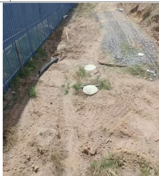
隔油池、化粪池
