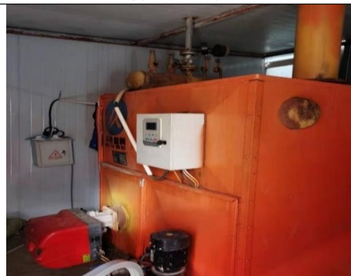
生产区燃气锅炉
