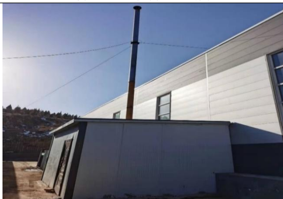
生产区锅炉房+排气筒
