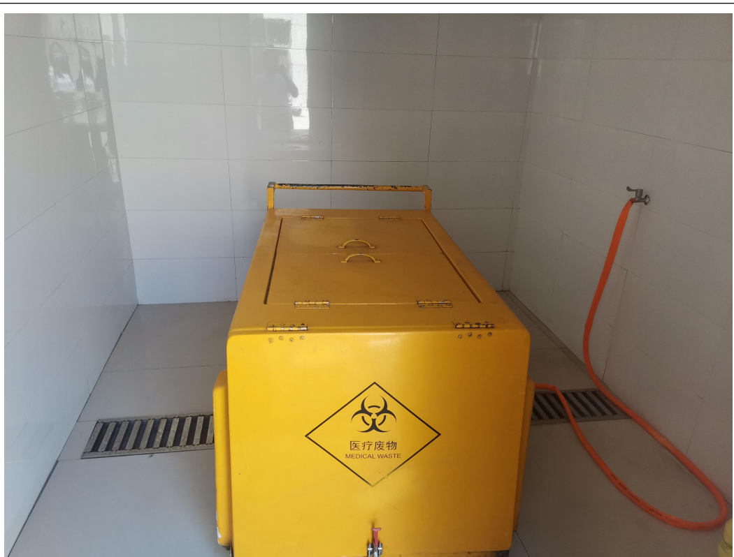
医疗废物清洗间
