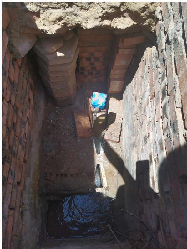
污水处理站流量计
