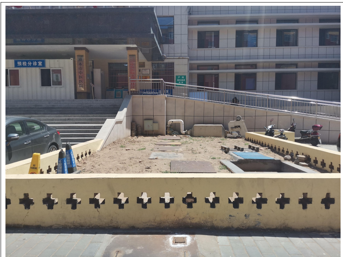
地埋式一体化污水处理设施
