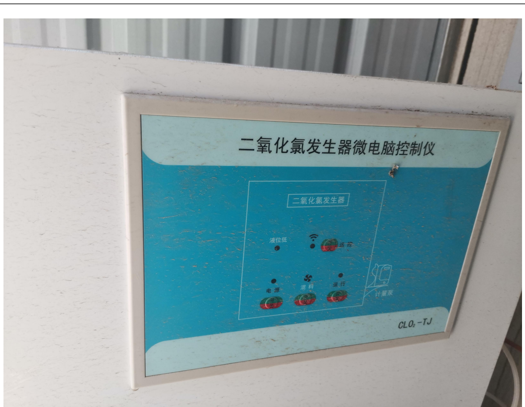
检验科污水消毒装置
