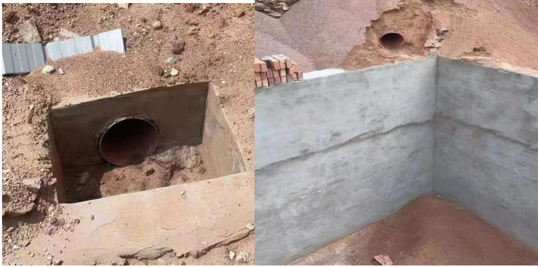
集水管和雨水集水池
