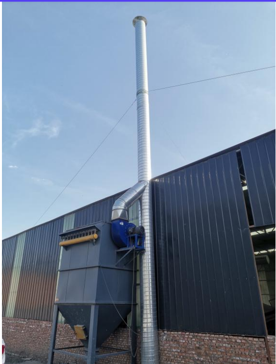
破碎筛分工段除尘器
