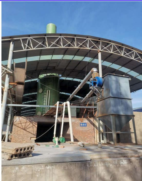
隧道窑脱硫设施
