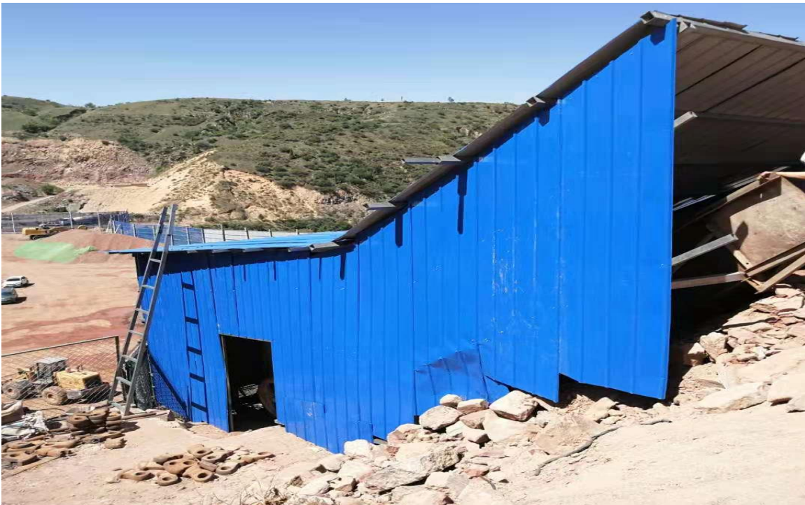
封闭车间（破碎）
