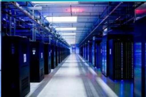
大型数据中心
