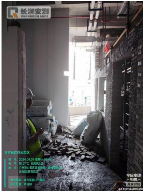
DSA 手术室东侧（控制室、设备间）
