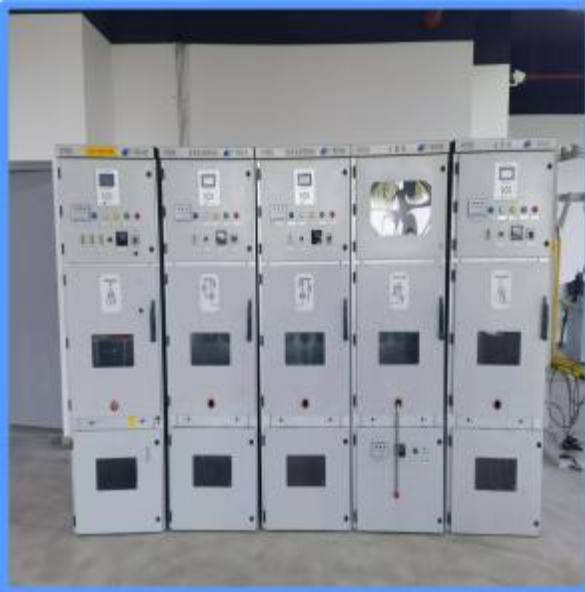
高压 电工 设备
