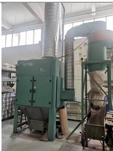
“旋风除尘+滤芯除尘” 废气处理设施
