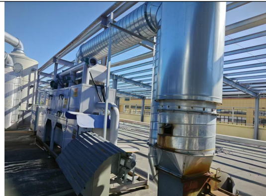
“水喷淋+除湿+活性炭吸附+脱附+催化燃烧装置” 废气处理设施
