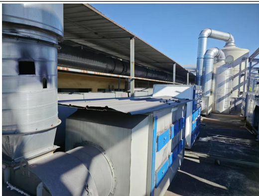
“水喷淋+除湿+两级活性炭吸附” 废气处理设施
