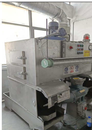
“水喷淋” 废气处理设施
