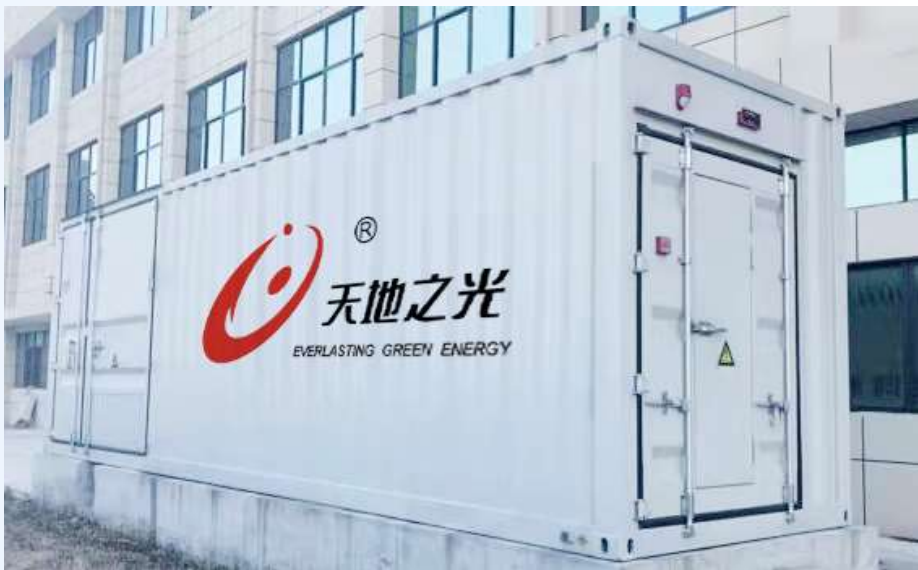
铅晶电池数字储能系统照片1
